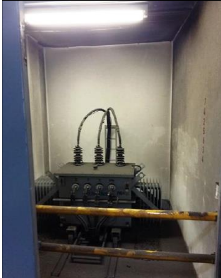
Imagen 9- Transformador de 300 KV
