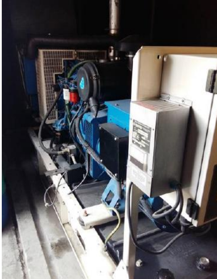
Imagen 10- Planta Eléctrica de Emergencia
