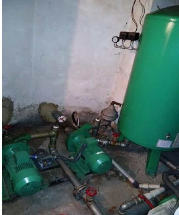
Imagen 8 - Sistema de Bombeo de agua potable
